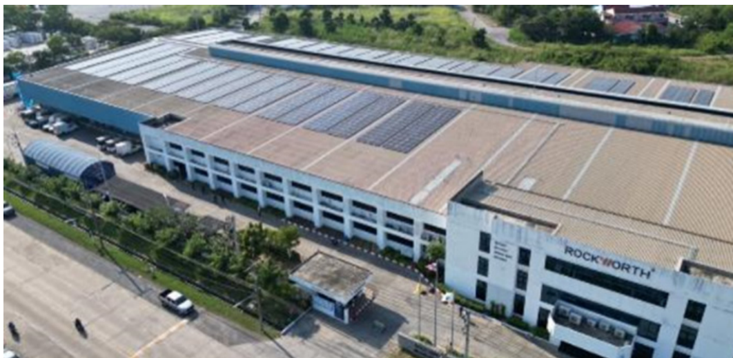
แสดงภาพการติดตั้ง Solar Rooftop ขนาด 654.36 kW บนหลังคาโรงงานบางปะอิน
